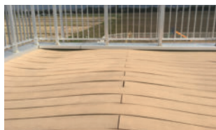
吸水によってデッキ面の盛り上がりが発生してしまう
