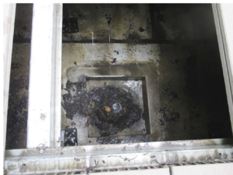
【写真】原因2：ごみで詰まったルーフトレーン
