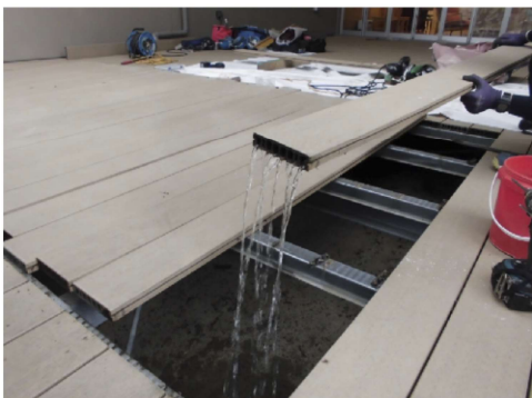
【写真】原因1：デッキ中空部に溜まった雨水
