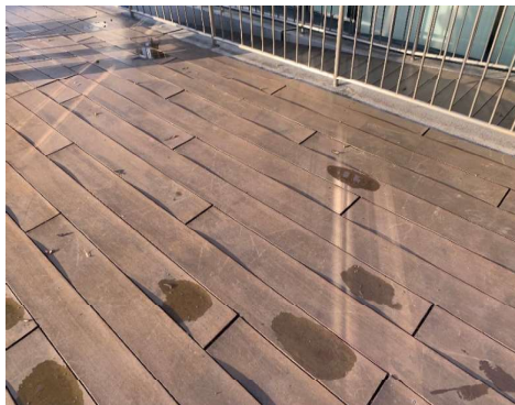
長年使用で変形したデッキ
